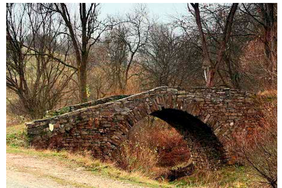
Камінний мосток ведучий до церкви (стан перед ремонтом). Фот. Бартломеї Вадас beskid-niski.pl
